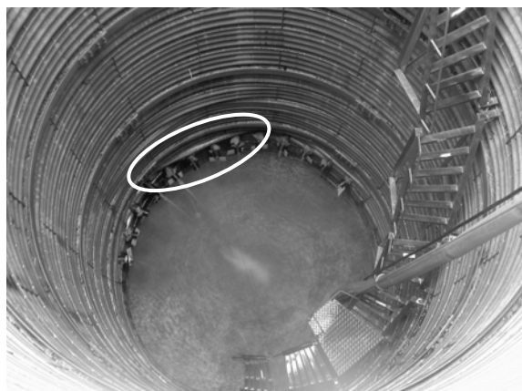
写真.1 集水井内の変形状
