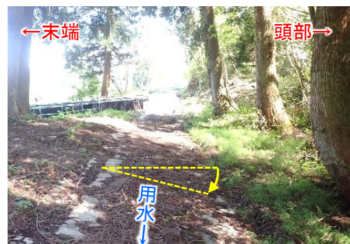
④ 用水路の傾倒
