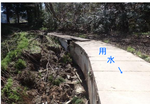
③ 用水路の破断と擁壁の崩壊
