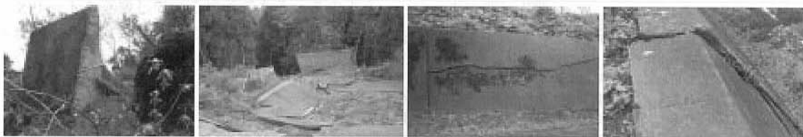
写真-3 擁壁の被害(左より転倒した重力擁壁, 滑落したもたれ擁壁, 縦壁の亀裂, 擁壁頂部のずれ)
