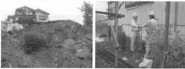
写真-1 玄関先まで地盤崩壊した宅地でのSWS試験
