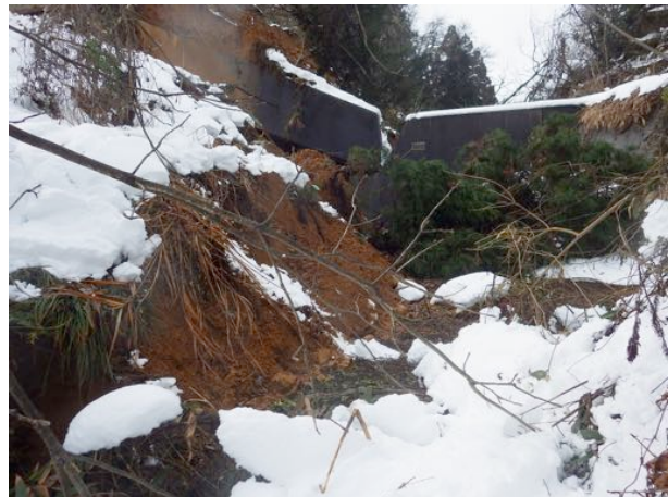
写真. 3 地すべり末端部の状況
